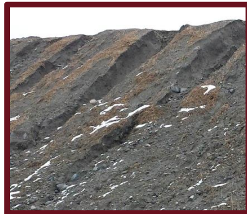
Pente comportant des défauts. Les côtés sont trop abrupts et mal compactés.
